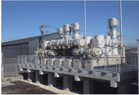
図3 84kVドライエア絶縁開閉装置
