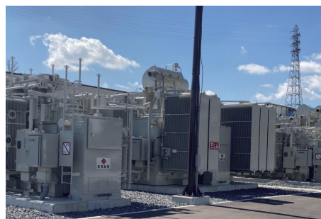
図1 新設変電所に導入した植物油変圧器
