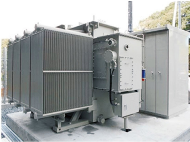
第9図 配電塔用変圧器(6MVA)
